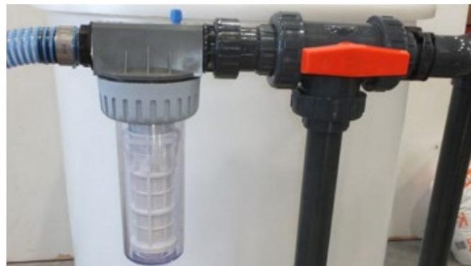
Kraftigt filter og 3-vejsventil
